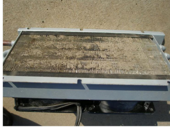
(e) Cooling Fan Clogging
